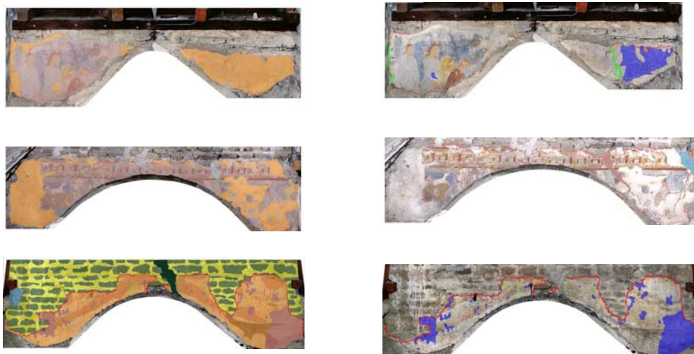
Fig. 7: Den vänstra spalten med bilderna visar att stora delar av intonacon har fallit bort. Små rester efter intonaco på västväggen tyder på att även den kan ha varit bemålad. Sprickor och lösa intonacokanter där intonacon är på väg att spjälkas bort förekommer på östväggen samt sydväggen.
