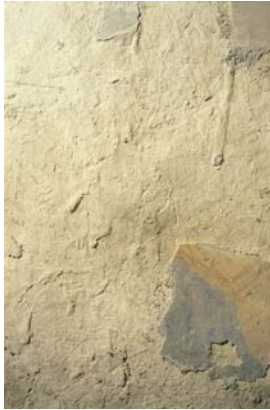
Fig. 21: Omfattande bortfall av intonaco visar tydliga rinnspår i kalkskiktet.
