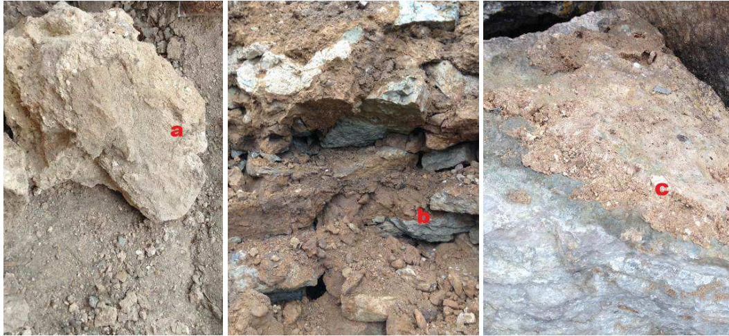
Figur 3: Det feta kalkbruket (a) är vitt och relativt homogent. Många små kalkklumpar förekommer. Bruket har en mycket god vidhäftning till kalkstenen där det använts som sättbruk. Lerbruket (b) i murkärnan är i god kondition innebärandes att det är stabilt när det är fuktigt och smular när det är torrt. Det har fyllt upp hela nedre murkärnan ihop med skrotsten. Kalkbruket från den andra byggnadsfasen (c) har mycket god vidhäftning till kalkstenen och är generellt välbevarat trots sin utsatta exponering för fuktinducerad nedbrytning.
