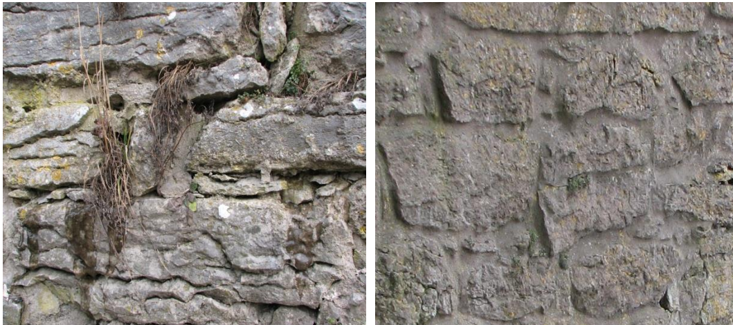
Bild 6.7: Exempel från Visby ringmur visar urlakade kalkfogar bakom cementfogar på södra muren liksom oförstörda cementfogar på västra muren. Så länge fogarna inte har börjat spricka ifrån så har heller inte det accelererade förfallet börjat synas. Det är ovisst hur fort förfallet påverkas då cementfogen väl börjat spricka.
