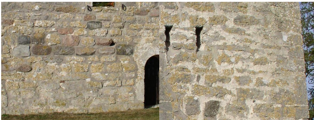
Bild 5.33 Där omfogning har skett med cementbruk är fallet ofta att de ej är helt utfyllda, vilket är att jämföra med de bevarade fogar som byggnaderna kan uppvisa i kalkbruk. Exempler kommer från Gothems kastalruin på Gotland.
