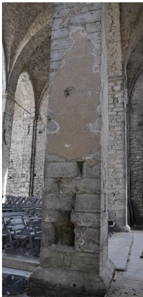
Bild 5.6. Pelare B4 åt norr ett år efter utförda kantförstärkningar (2011).
