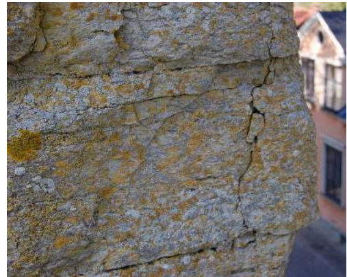
Bild 5.10 Detaljerad bild av hörnkedja där kalkstenen har spruckit sönder och material tenderar att spjälka av. (2009)
