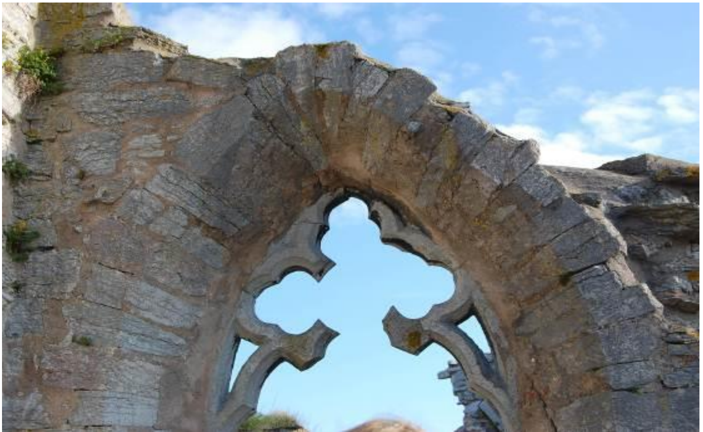
Bild 5.17. Detalj av ett masverksfönster där delar av den dekorativa utsmyckningen gått förlorad. Murkrönet är täckt av ett skyddsskikt i cement. I det vänstra övre hörnet ses hur vegetation har slagit rot i de söndervittrade fogarna.(2009)
