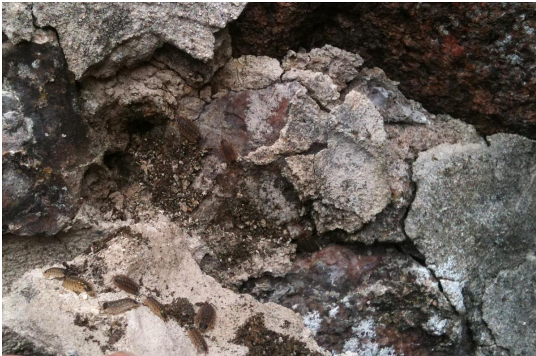
Bild 5.31 Gråsuggor bakom cementfog på Kronobergs slottsruin.
