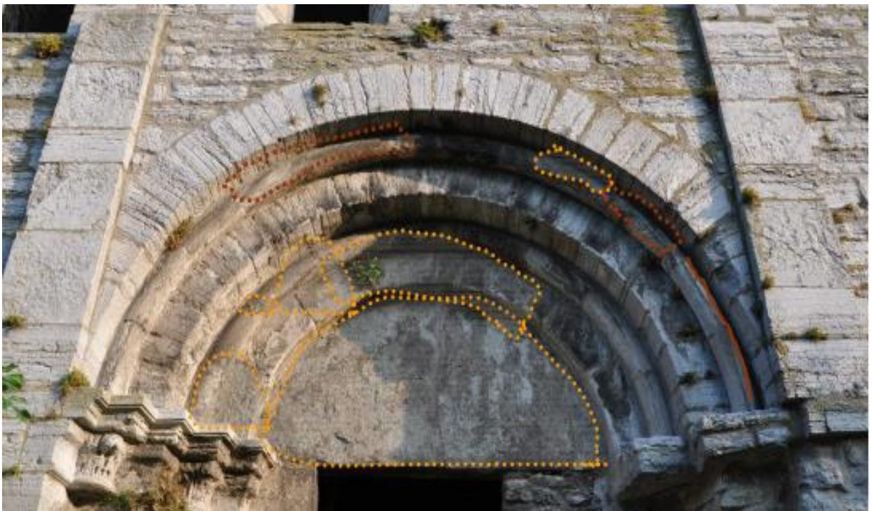
Bild 5.20 Sydöstra långhusportalen. De gulmarkerade områdena anger ytor med omfattande ytspjälkning av sten och de römarkerade områdena var spjälkande sten som fixerades år 2011.
