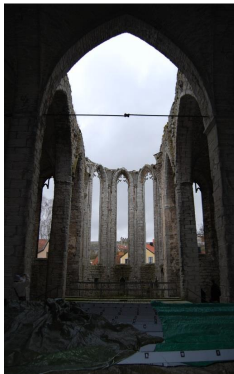
Bild 8.2 Hålet i taket på ruinens östra sida.
