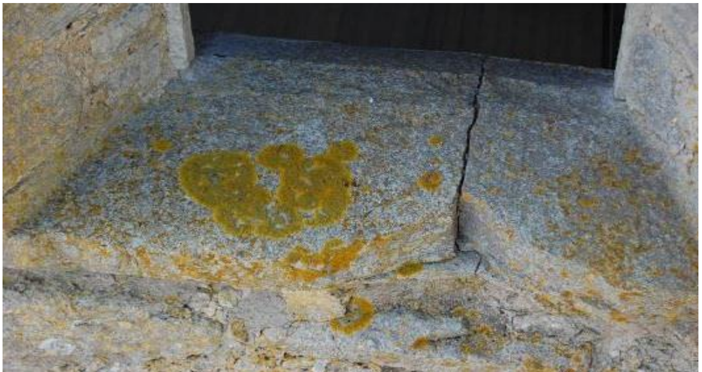
Bild 5.18. Detalj av en solbänk på norra fasaden som har en genomgående sättningspricka där vatten letar sig in och i förlängningen orsakar skador i murverket. (2009)
