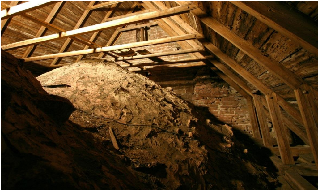
Figur 7.12. Ovansidan av kryssvalven över långhuset på Rogslösa kyrka i Östergötland. Valven är kupolformade och mycket stigande.
