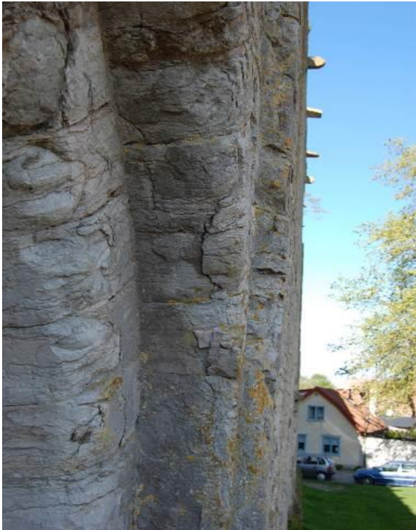
Bild 5.13. Detalj av den norra långhusportalen. Här ses exempel på spjälkande sten. (2009)
