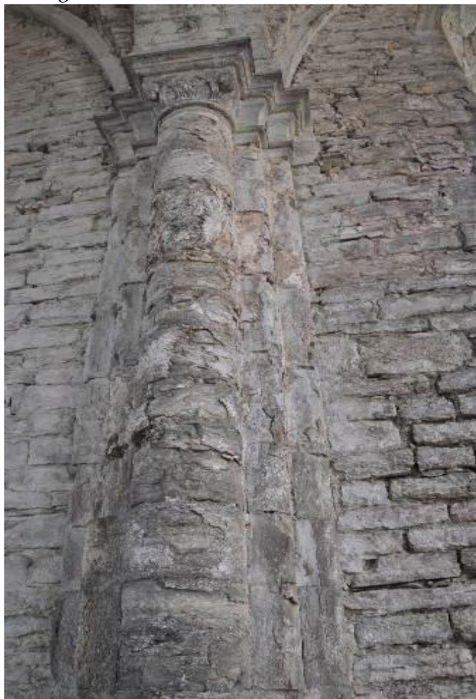
Bild 5.2. Pilaster mot södra muren. Observera den kraftigt spjälkande stenen som sannolikt orsakats av brand. (2010)
